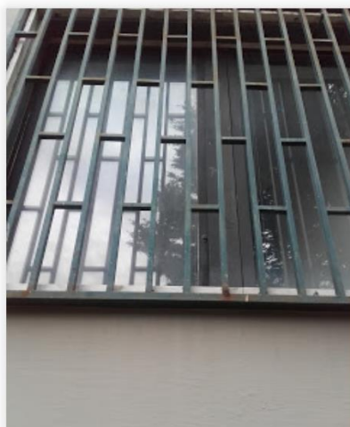
Finestra, unica della classe, bloccata per sicurezza
