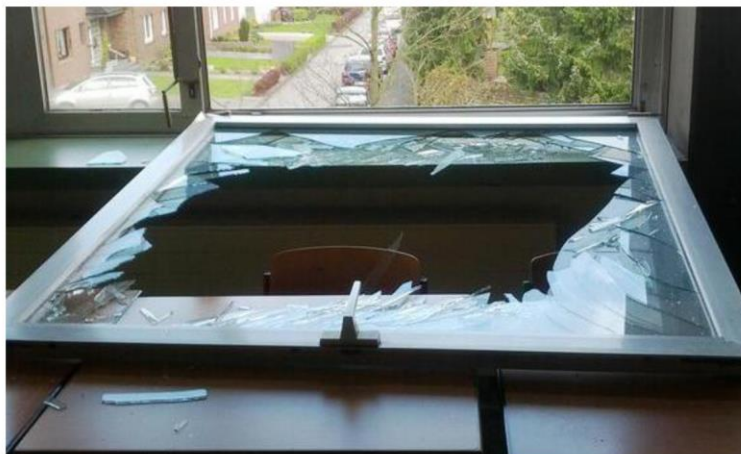
Das abgestürzte Fenster im Gymnasium. Foto: Privat
